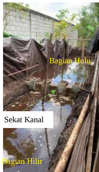
Gambar 10. Keadaan saat pengujian gerusan (Sumber: Hasil dokumentasi lapangan)
